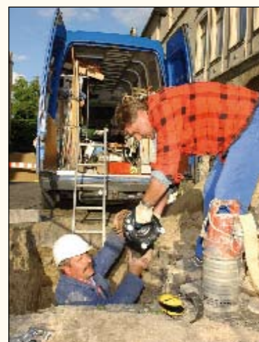
Vorsicht bei Arbeiten im Erdreich: Ver- und Entsorgungsanlagen könnten beschädigt werden Foto: max
