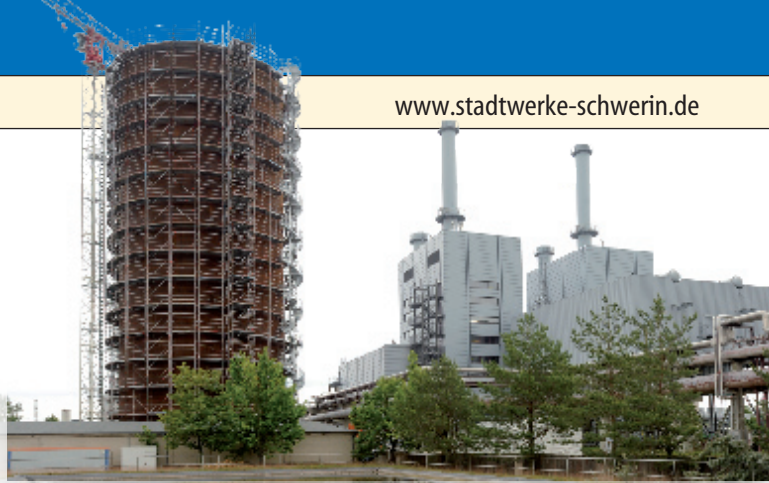
Noch ist der neue Wärmespeicher hinter dem Heizkraftwerk in Schwerin-Süd eingerüstet. Im Oktober soll er in Betrieb genommen werden Fotos: max
