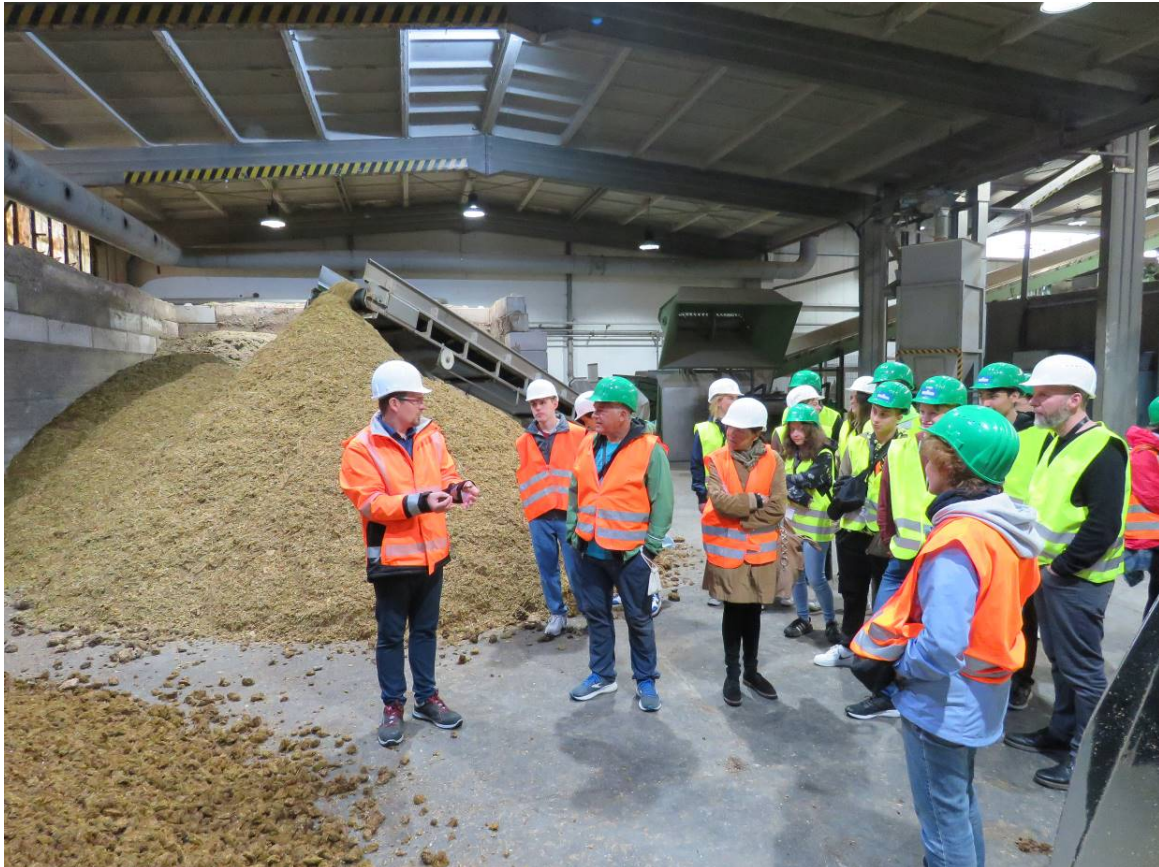
BU: René Tilsen (links), Leiter der Stadtwerke-Kraftwerke, erklärt die Funktionsweise der Biogasanlage. Foto: SWS
